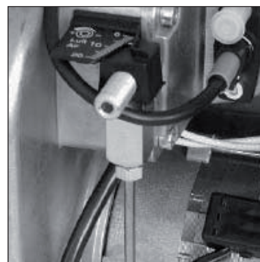
Рис. 16: Регулировка подпорной шайбы горелки
