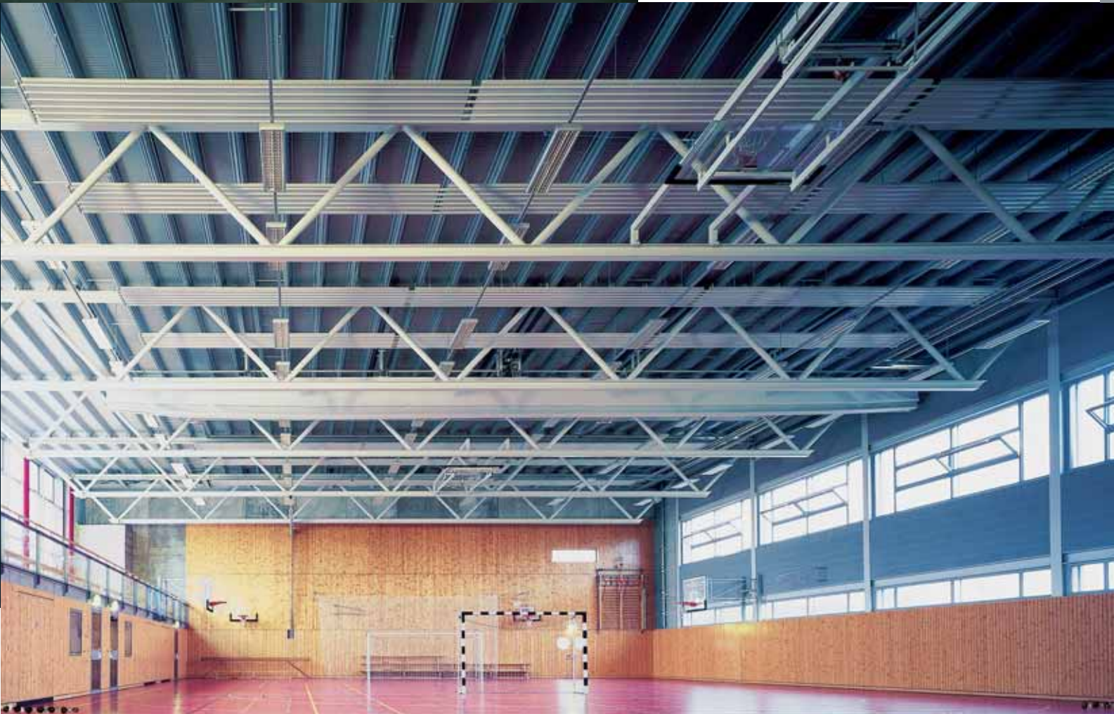
Спортзал в Хенигсдорфе. Потолочные панели Zehnder с защитной сеткой от попадания мяча.
