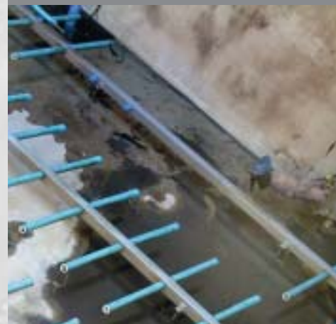
TR 50-2 в аэрационном резервуаре
