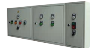
Приточная установка с электрическим нагревом (2 ступени), двигатель без частотного преобразователя
