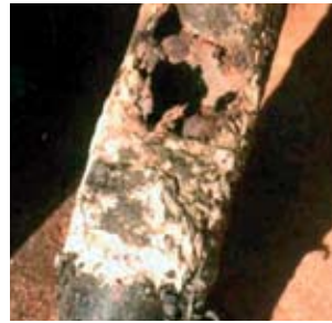
Рис. 3. Труба газопровода, сильно поврежденная коррозией
