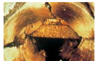
Рис. 6. Сильно поврежденная канализационная труба
