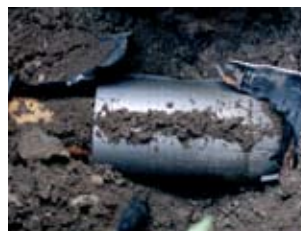
Рис. 65. Разрушение трубы с заменой при помощи труб Wavin TS в Познани, Польша
