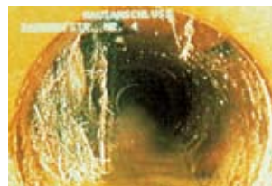
Рис. 5. Повреждение канализационной трубы корнями
