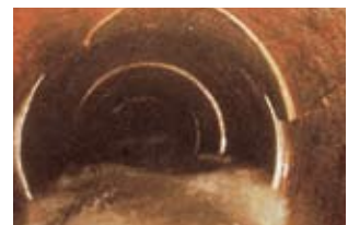
Рис. 4. Структурные повреждения и отложения в канализационной трубе
