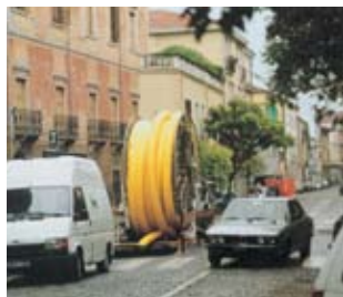
Рис. 55. Compact Pipe в Падуа, Италия
