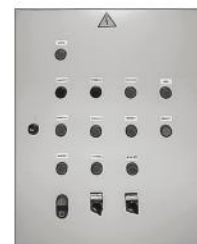
Шкафы управления воздушно-тепловыми завесами
