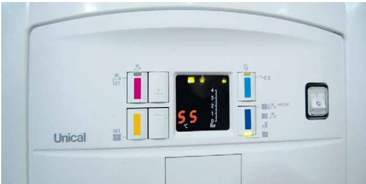
Панель управления котла ALKON 50 / 70
