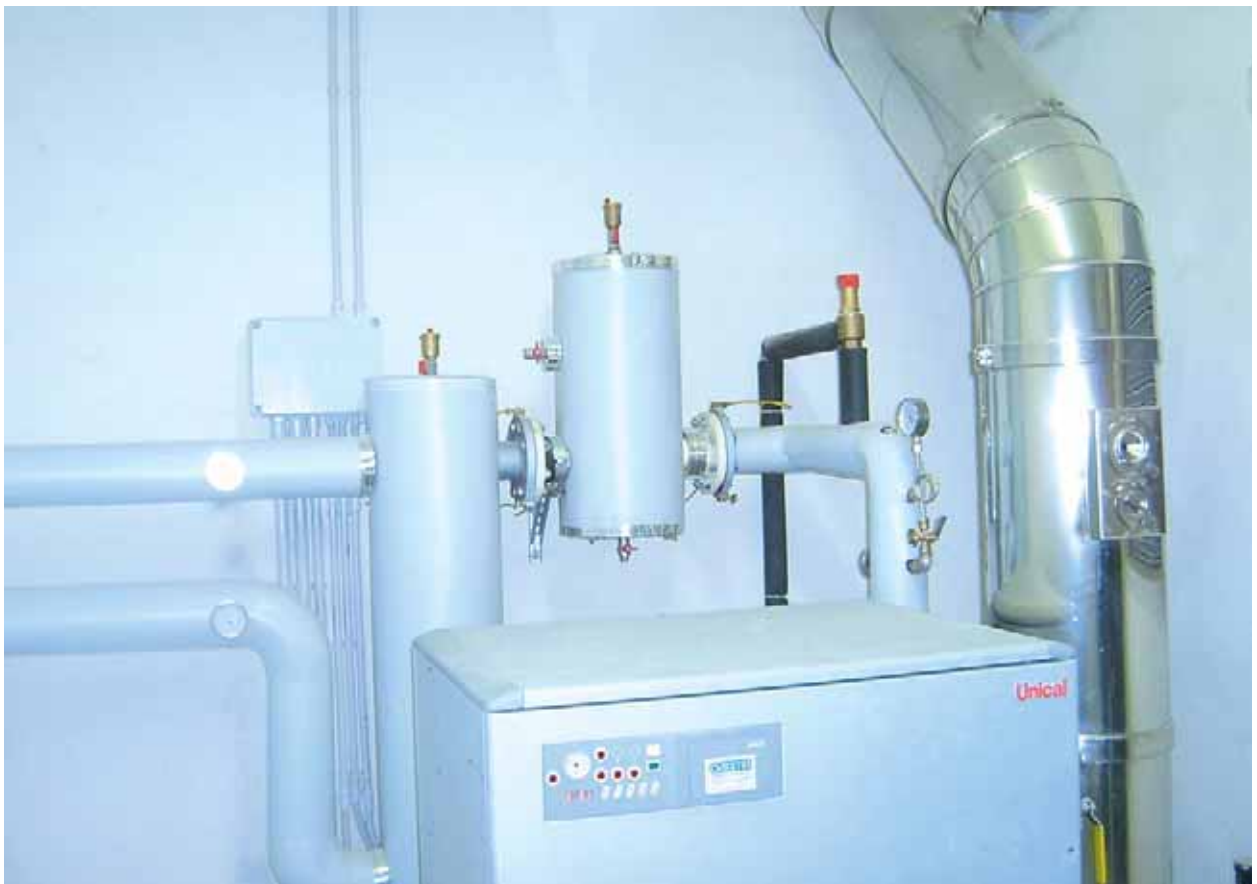
Котельная на базе котла MODULEX
