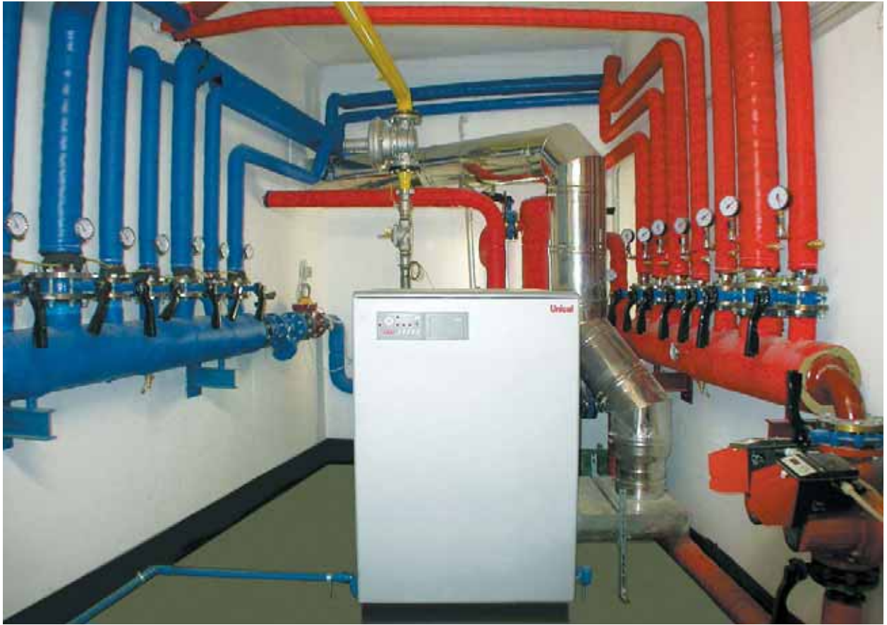
Котельная на базе котла MODULEX
