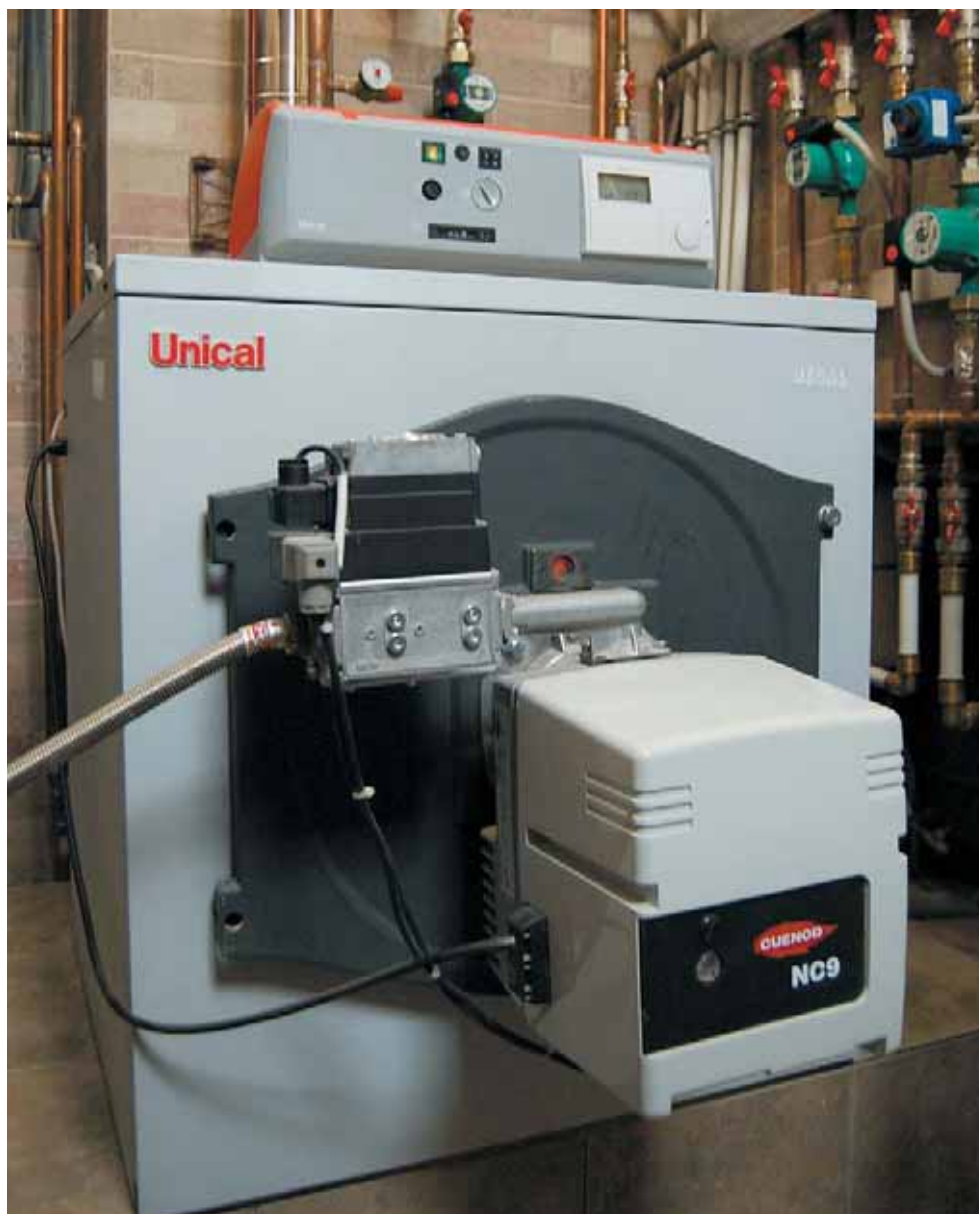
Котельная на базе котла RECAL.
