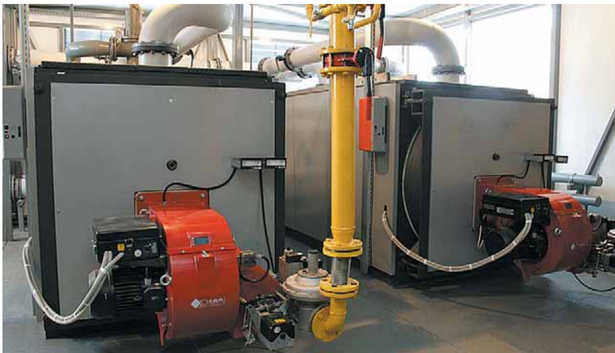
Котельная из котлов ELLPREX.
