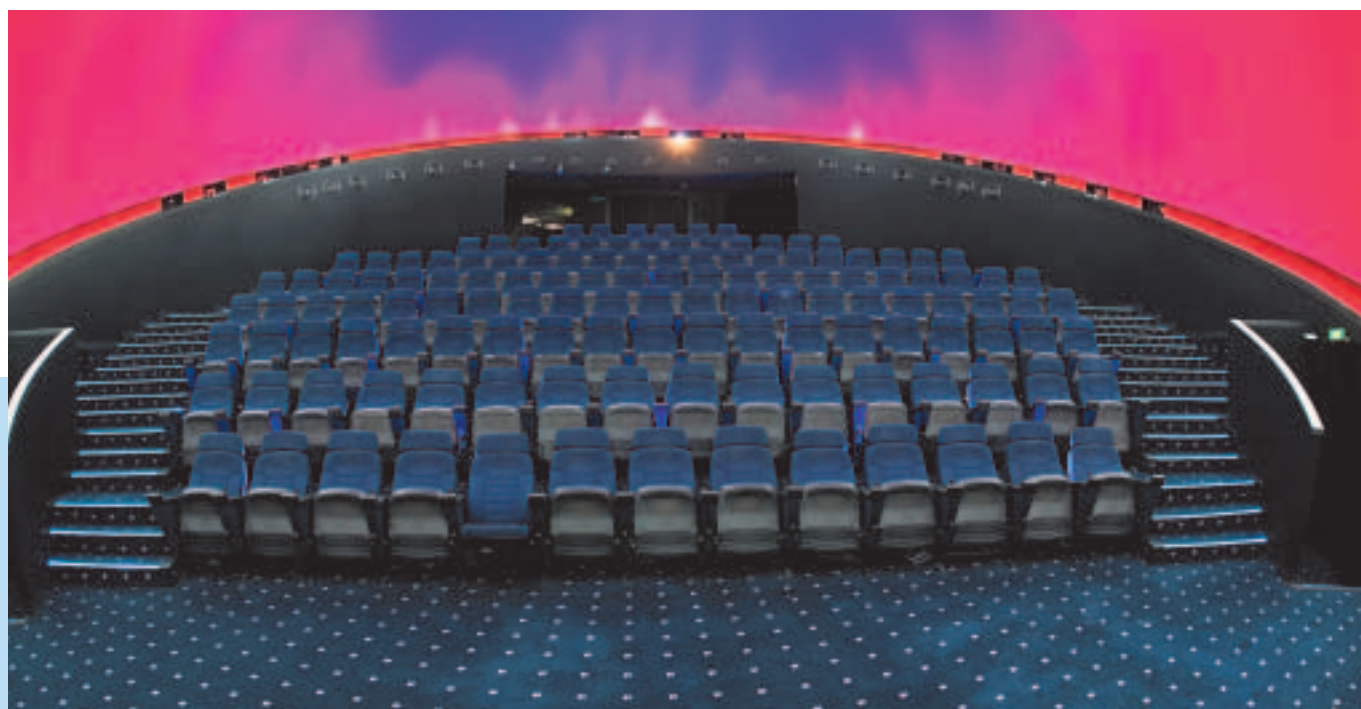
Театр Толос, Афины, Греция Воздушная система кондиционирования воздуха с соплами и установленными вихревыми воздухораспределителями в ступенях подъема.
