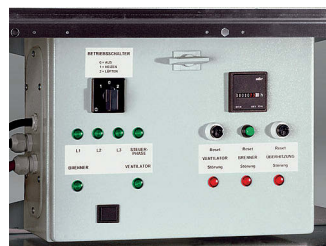
Встроенный распределительный шкаф
