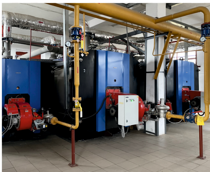
Котельная из котлов TITAN Prom 2 мВт и 4 мВт для теплоснабжения микрорайона в г. Шилово Рязанской области
