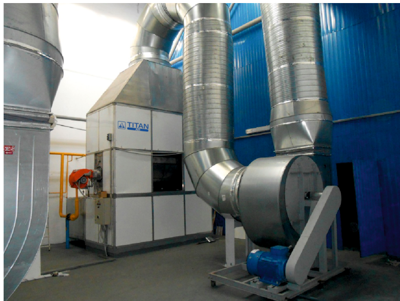
Воздухонагреватели TITAN AIR 920 VSV успешно отапливают завод по выпуску оборудования для добычи, транспортировки и переработки углеводородов в г. Сасово Рязанской области
