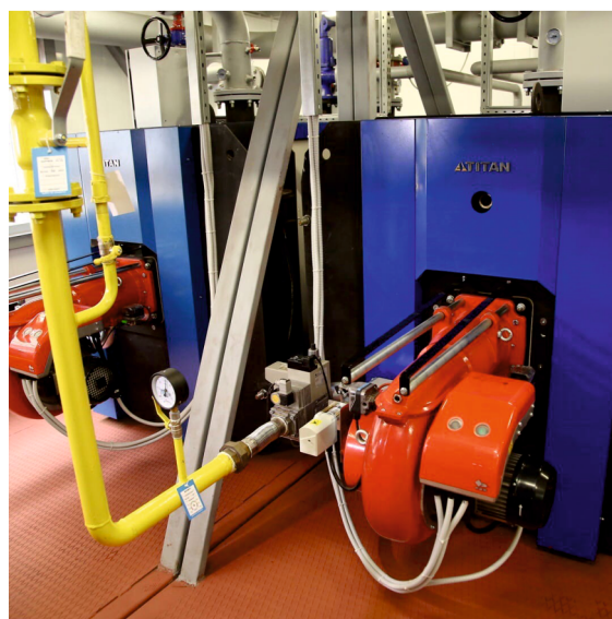
Котельная из трех котлов TITAN Prom 1500 в Ульяновской области
