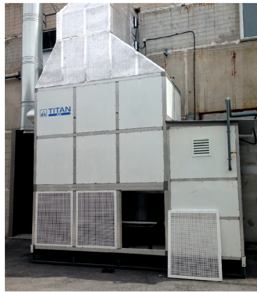
Один из крупных проектов Газтехпром – каскад воздухонагревателей TITAN AIR 800 NSV, отапливающих фабрику по производству мебельной фурнитуры в г. Миасс Челябинской области
