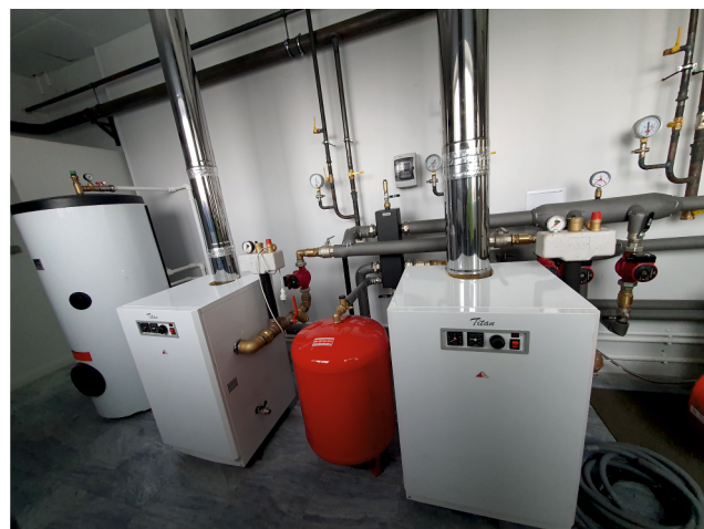
Котельная мощностью 113 кВт для отопления помещений фармацевтической компании в п. Оболенск Московской области. На фото каскад из котлов TITAN Z60 и TITAN Z65
