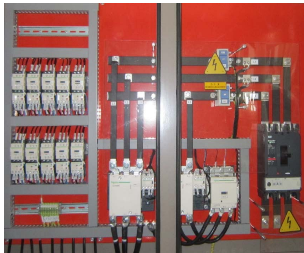
Блок пускателя (сторона высокого напряжения)
