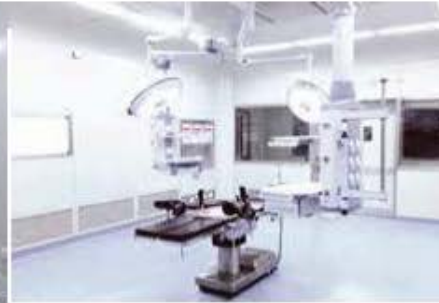
Система очистки воздуха в операционных блоках
