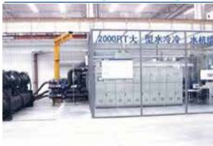
Стенд для испытаний чиллеров с водяным охлаждением мощностью до 2000RT (7034 кВт)
