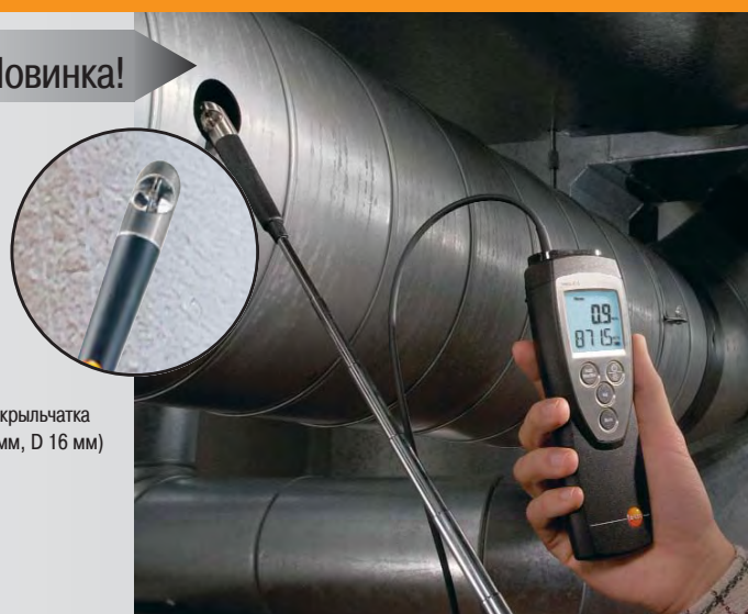
Мониторинг объемного расхода в воздуховодах
