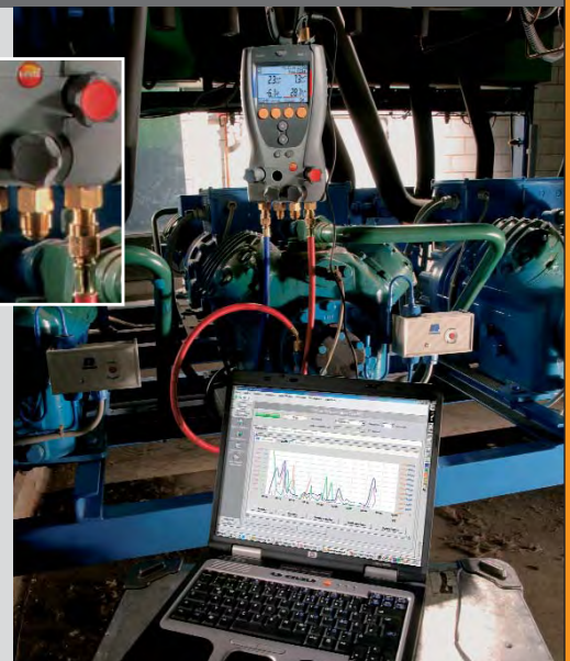
Сервис и обслуживание холодильных систем с использованием testo 556 и 560, включая пуско-наладочные работы
