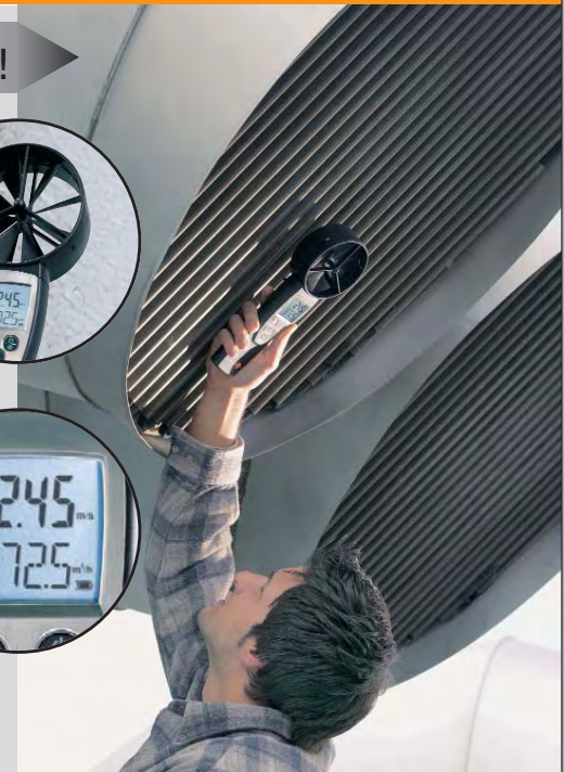
Измерения объемного расхода с помощью крыльчатки диаметром 100 мм на выходах воздуховодов
