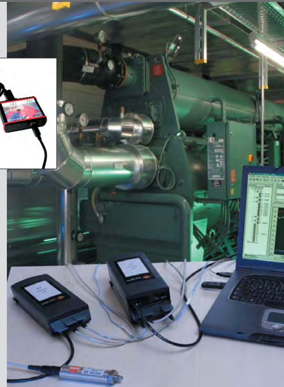
Измерение значения перегрева/переохлаждения и определение давления масла в промышленных холодильных системах
