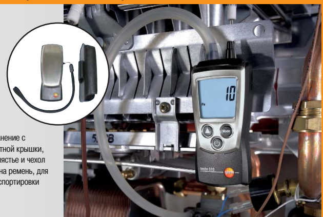
Измерение дифференциального давления в системах газового отопления
