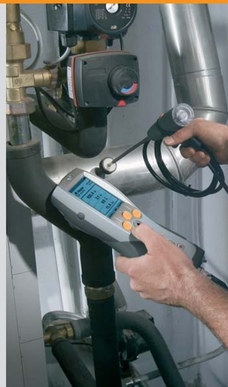
Измерение концентраций дымовых газов на котле
