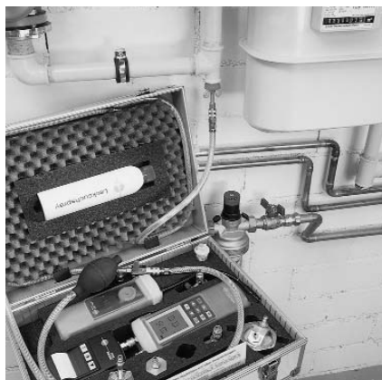
Проведение предварительных тестов с использованием прибора testo 312-3
