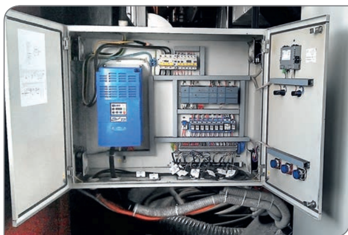
Компановка щита управления на базе Siemens
