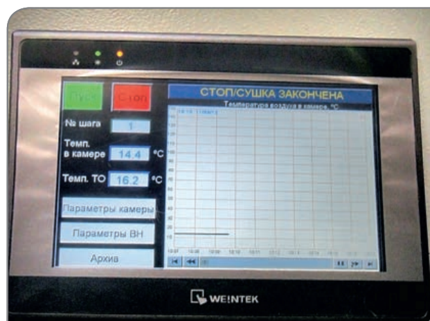
Панель оператора установленная в щите управления на воздухонагревателе используемом для технологических процессов
