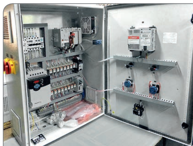
Компановка щита управления на базе Rockwell
