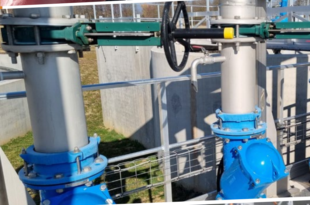
STATION DE TRAITEMENT DES EAUX USÉES WWTP Vietnam
