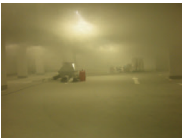
Испытания на этапе ввода в эксплуатацию
