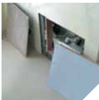
Sanipack установлен за стеной
