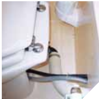
Вид на соединения унитаза системы Sanimarin
