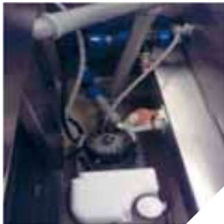
Sanicom, установленный за плитой
