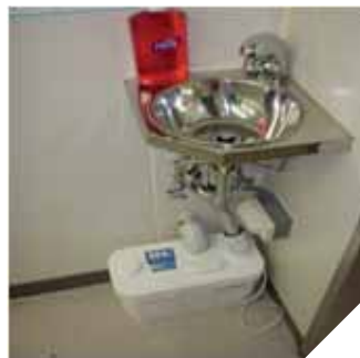
Sanivite, установленный в комнате 1
