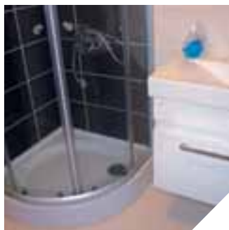
Душ, подключенный к Sanishower, скрытому за стеной
