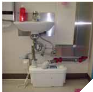
Sanivite, установленный в комнате 2
