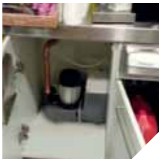
Sanicom, установленный в шкафу
