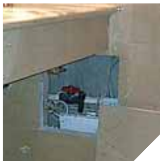
Sanipack установлен за стеной с монтажным люком
