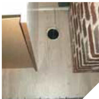
Дренажная труба, проведенная из подвала на кухню
