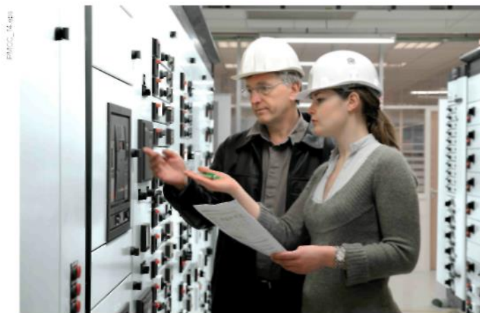
Щит управления двигателем (MCC)
