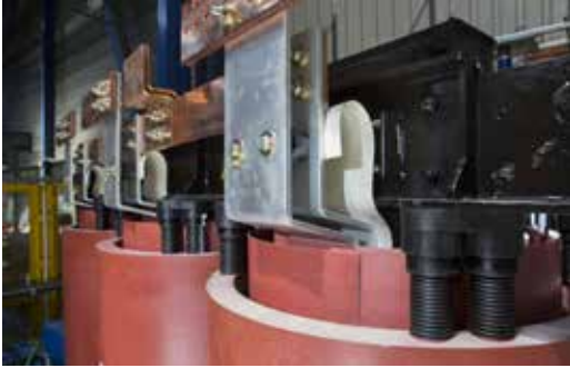
Распорные клинья обмотки ВН
