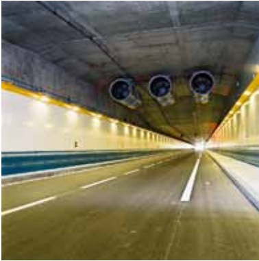
Установка для очистки воздуха
