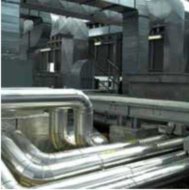
Установка для кондиционирования воздуха
