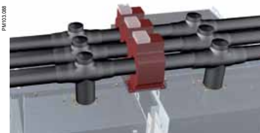
Трансформатор тока сборных шин
