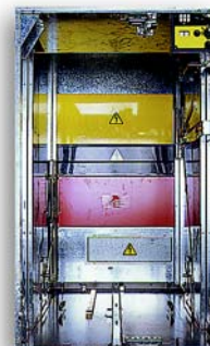
Отсек автоматического выключателя
