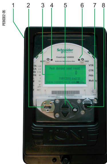
PowerLogic ION8650 в щитке
