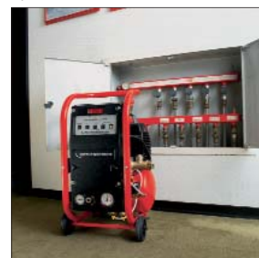
Промывка системы отопления пола
