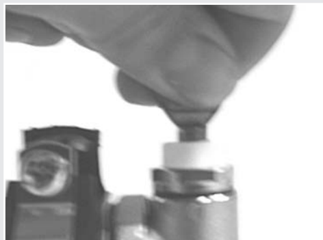
Die Entlüftung des Heizkreisverteilers kann durch die Füll- und Entleerungsstopfen manuell erfolgen. Die Entlüftungskappe ist mit einem Entlüftungsschlüssel leicht zu öffnen, bis die gesamte Luft entwichen ist. Anschließend ist diese Entlüftungskappe wieder zu verschließen.
