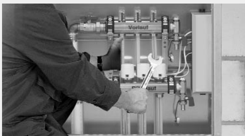
Roth Heizkreisverteiler mit DFA absperrbar
