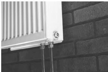
Непосредственное подключение трубы к радиатору с помощью медных L- и T-образных трубок
