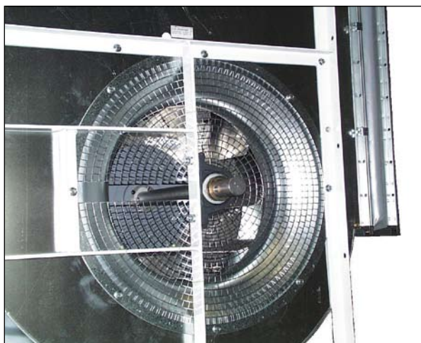
а) защита всасывающего отверстия вентилятора
