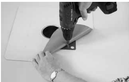
Рисунок 6.3. Водосливную воронку устанавливают на водоприемную трубу и механически закрепляют к основанию кровли (не менее чем в двух местах на одну воронку).
