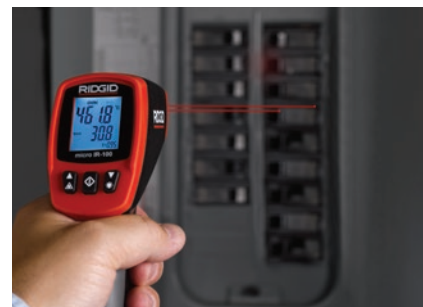
Проверка предохранителя или автоматического прерывателя на предмет перегрева, который могут вызвать перегруженные электрические цепи
