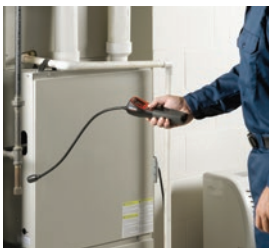
Он идеально подходит для подрядчиков, выполняющих сантехнические работы и обеспечивающих системы отопления, вентиляции и кондиционирования воздуха
