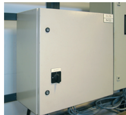
Силовой шкаф RK100
