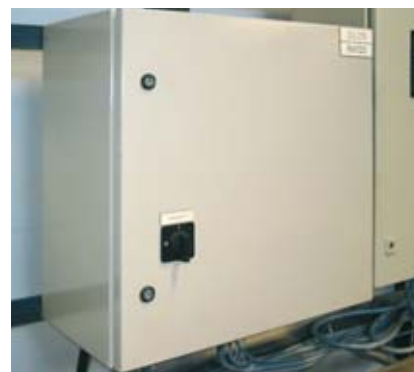
Силовой шкаф РК100
