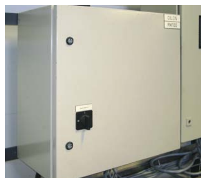
Силовой шкаф RK100
