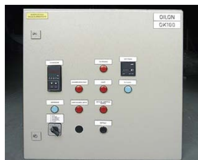
Шкаф управления ОК100
