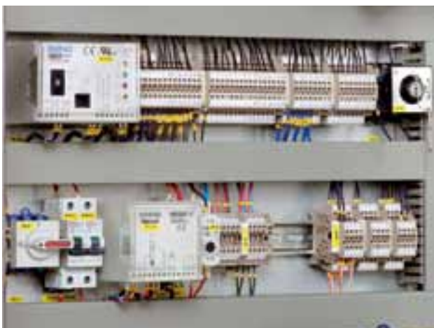
Оборудование безопасности системы BMS.
