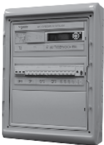
Щит управления CB1PL
