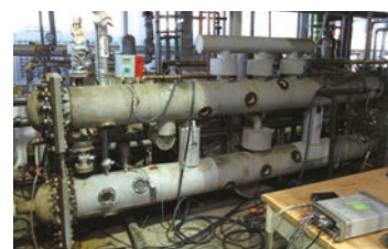
Площадка по испытанию и проектированию теплообменников
