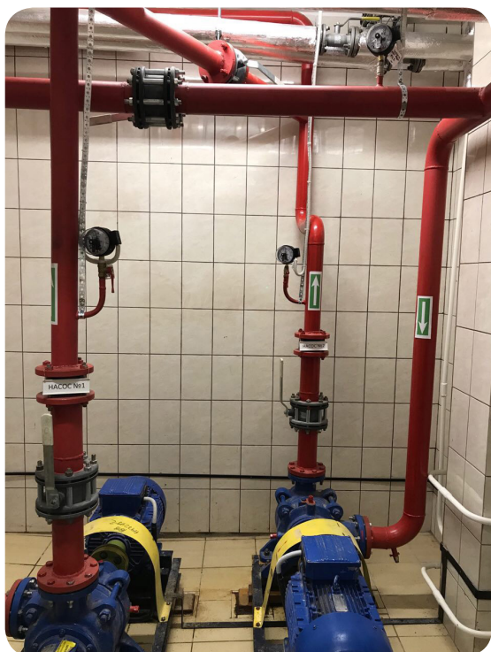
ИНДИВИДУАЛЬНЫЙ ТЕПЛОВОЙ ПУНКТ
