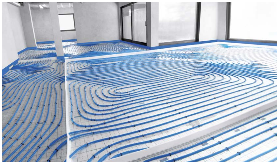
Рис. 24. Напольное отопление, выполненное в системе KAN-therm Tacker
