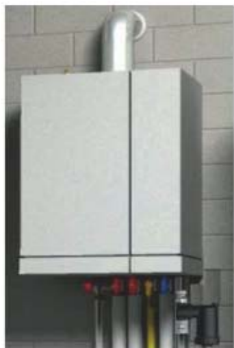
Магнитный сепаратор шлама SafeCleaner, установленный под котлом
