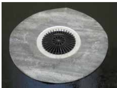
2. Нанести праймер, наклеить 1-й слой гидроизоляции
