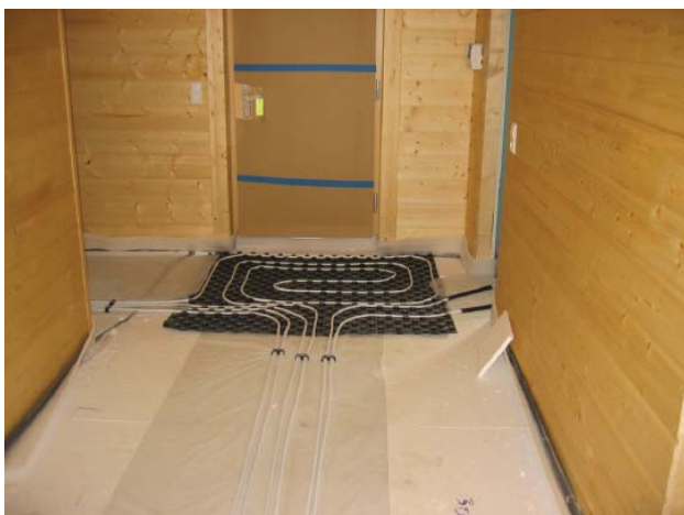
Панельное отопление в коридоре и прокладка трубопроводов
