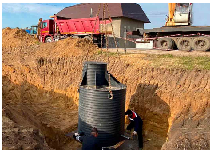
Объект: Завод холодильного оборудования, МО, д. Богослово Подрядчик: ООО «Простор-Л»
