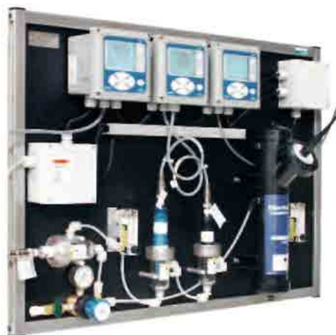
Рис. 8.10.6 Несколько приборов 1056 с коммуникацией по протоколу HART, показанных на панели для простой установки Plug-N-Plumb
