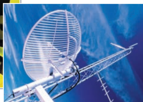
ТВ и радио приемная станция
