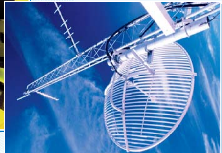
ТВ и радио приемная станция
