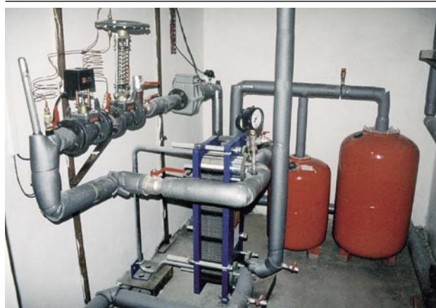
Рис. 2. Тепловой пункт здания с приборами автоматизации фирмы Danfoss
