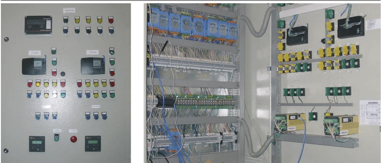
Рис. 64. Пример исполнения шкафа автоматики ЦТП с оборудованием для диспетчеризации по протоколам последовательных интерфейсов
