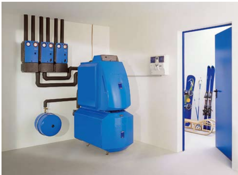
Напольный котел с бойлером ГВС
