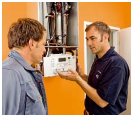
Программирование режимов работы котла
